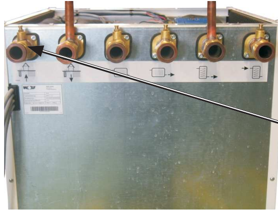
Handentlüfter im Sole-Eintritt
