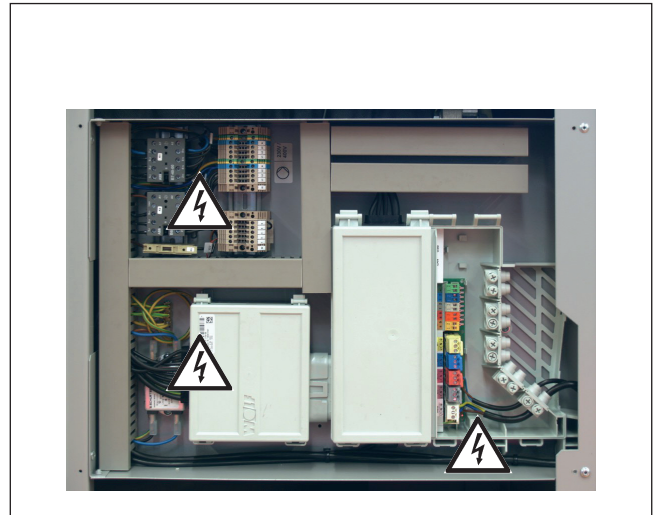
Bild: Steuerungskasten Gefahr durch elektrische Spannung
